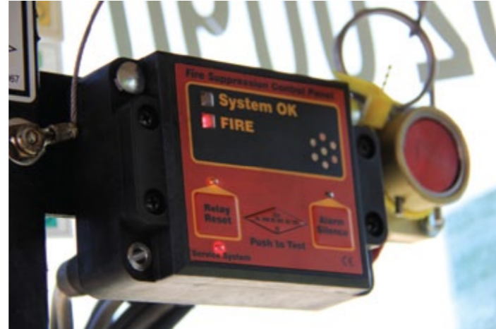
Quando a temperatura no cabo sensor atinge 180°C, o painel gera um alarme audiovisual de incêndio na cabine do operador
