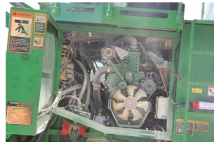
Vista do compartimento do motor e da bomba hidráulica após a descarga do agente extintor
