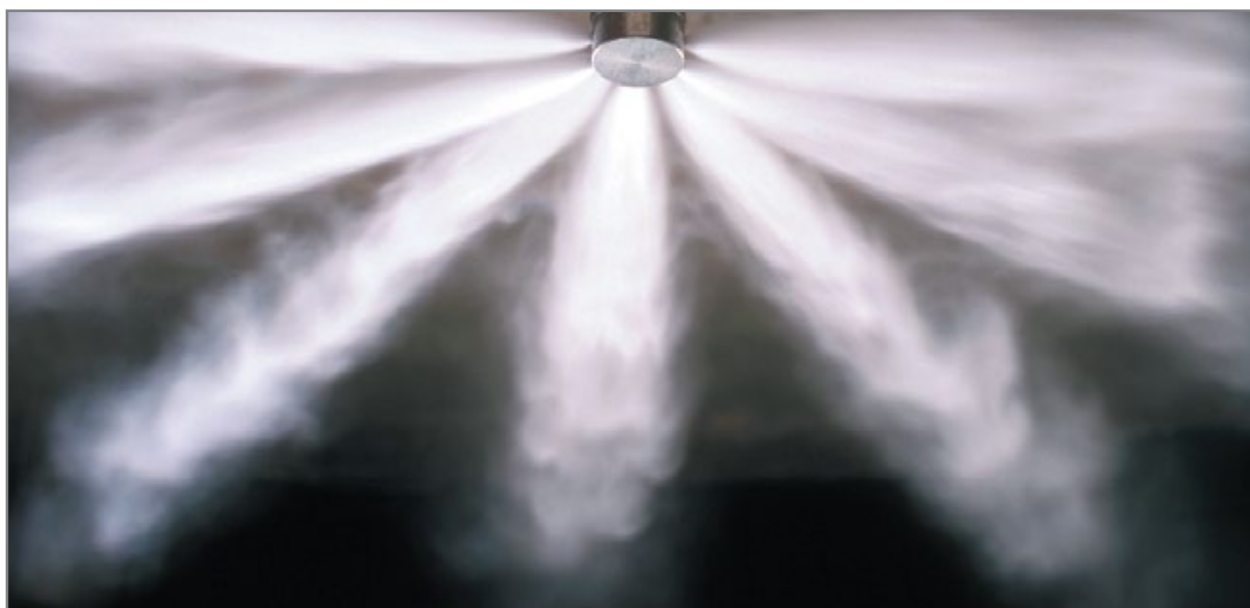
Descarga de Gás Novec 1230
